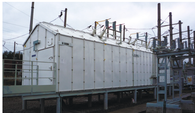
Ячейка в электротехническом блок-боксе УХЛ1
