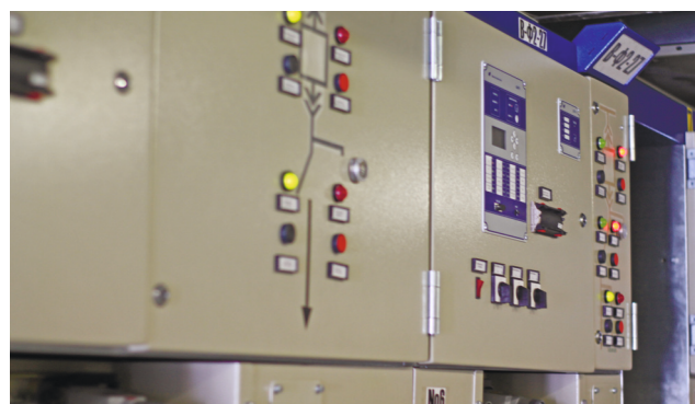
Вид на релейный шкаф
