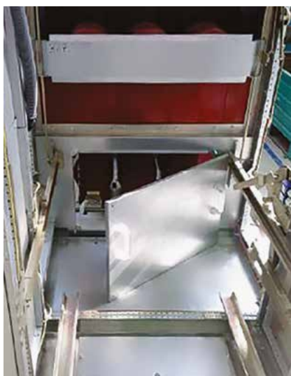
Съёмная перегородка в отсеке выкатного элемента
